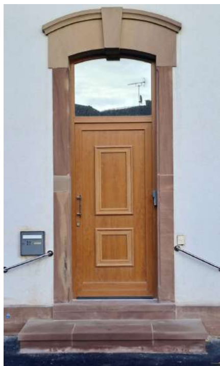
Pose d'un escalier en grès des Vosges pour l'accès au logement rue Principale.
